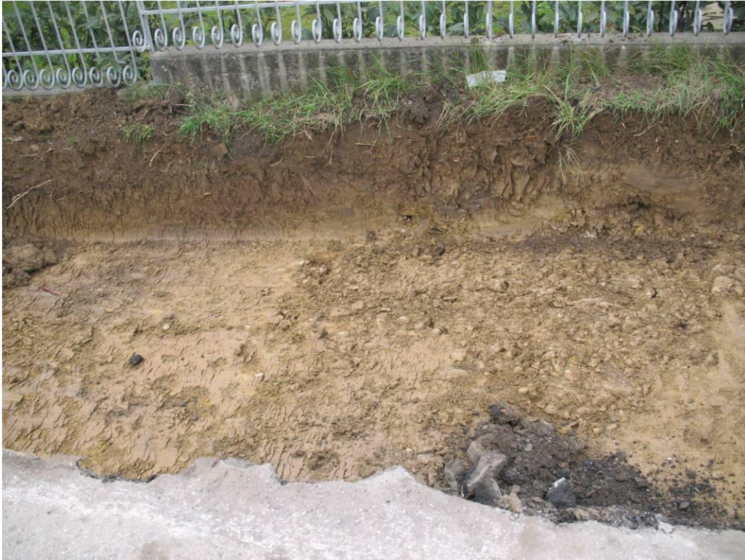
Fig. 6. Area interessata dai lavori stradali lungo via I Maggio, in cui si nota la presenza di un antico alveo con la presenza di ciottoli fluviali (Foto X. Gonzalez).
